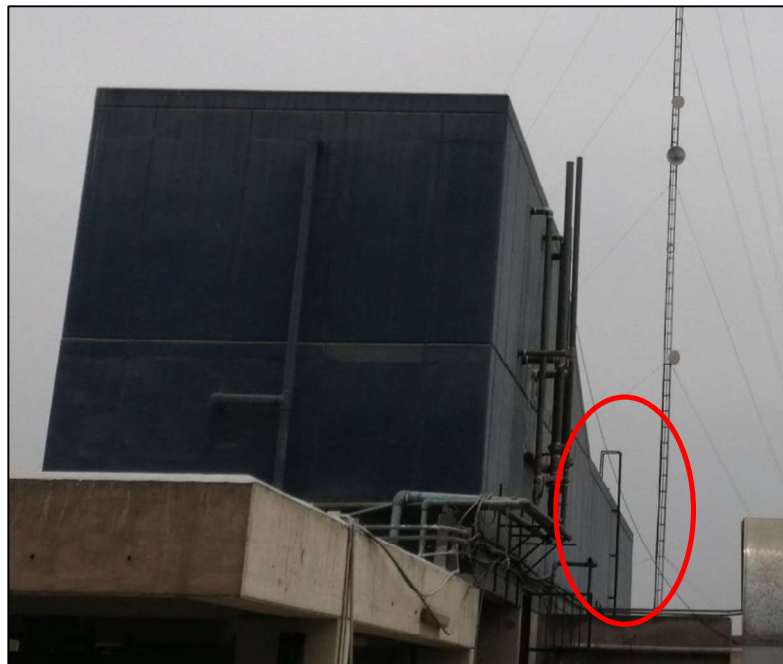
Fotografía N° 06. Vista del tanque levado y escalera metálica tipo gato sin protección de espalda.
