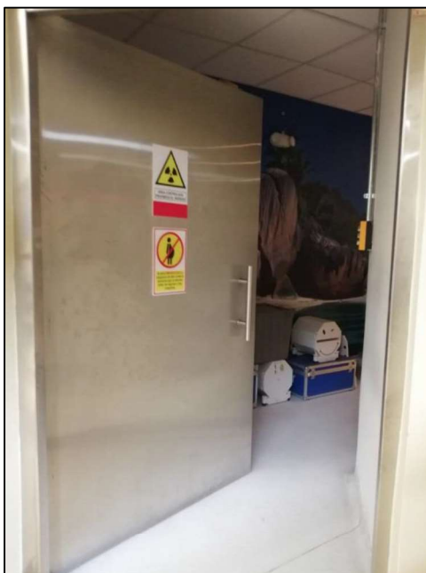
Fotografía N° 26. Puerta no cierra correctamente en EQUINOX 03.
