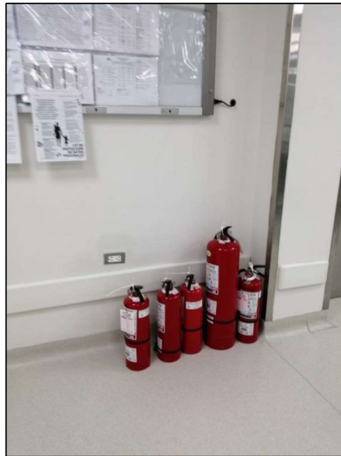
Fotografía N° 31. Falta de señalización y ubicación de extintores en Centro Quirúrgico.
