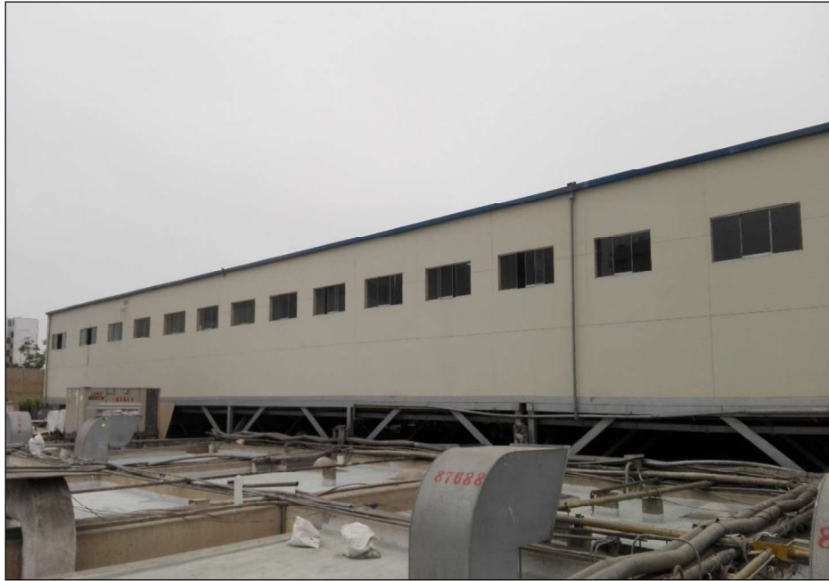
Fotografía 11. Vista de la infraestructura de material prefabricado que ha sido reforzada en la base
