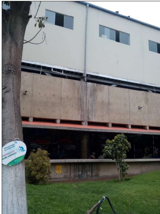
Fotografía 05. Observamos algunas afectaciones por el deterioro de líneas vitales de la infraestructura.
