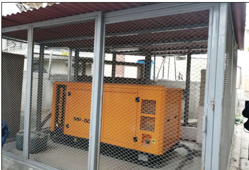
Fotografía N° 02. Grupo Electrógeno de 60 KW-75 KVA Modelo MP-60I.
