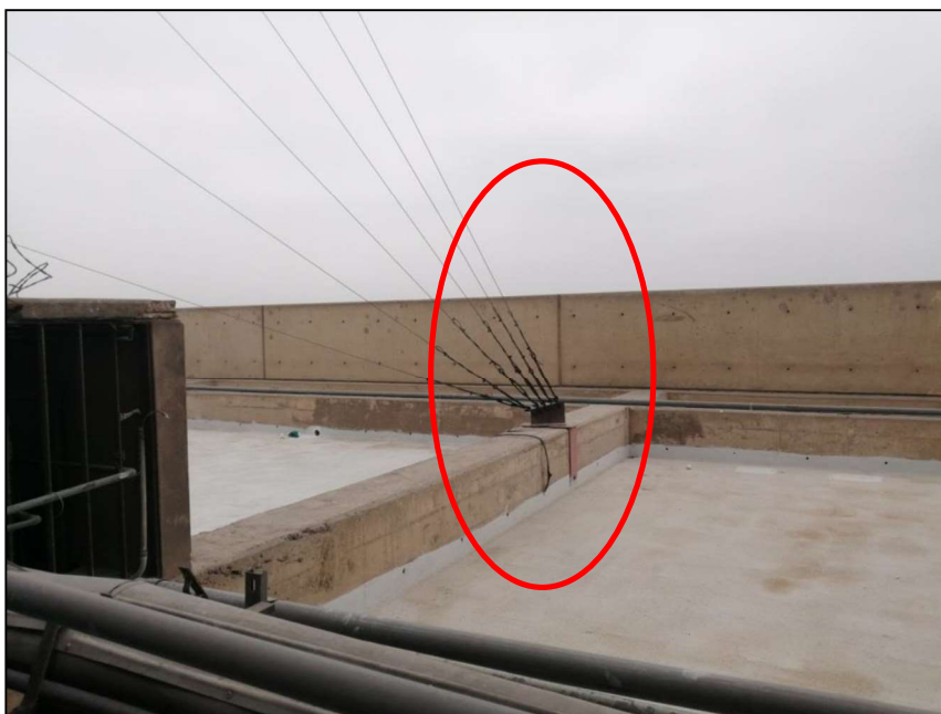
Fotografía N° 04. Vista de soportes, anclajes y tensores de las antenas, con presencia de oxido.
