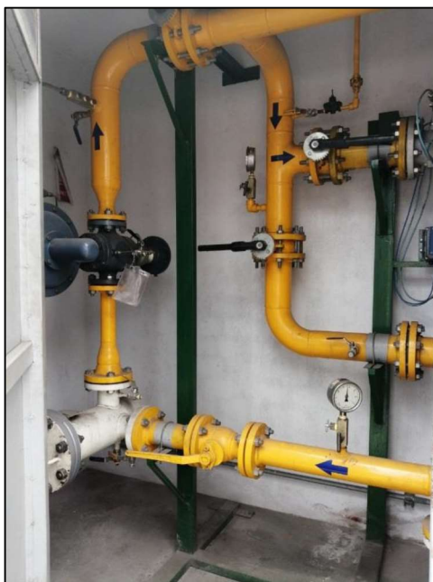
Fotografía N° 08. Depósito de Gas (GLP) de 38,712.68 sm3/mes de consumo utilizados para los calderos y cocina del establecimiento.
