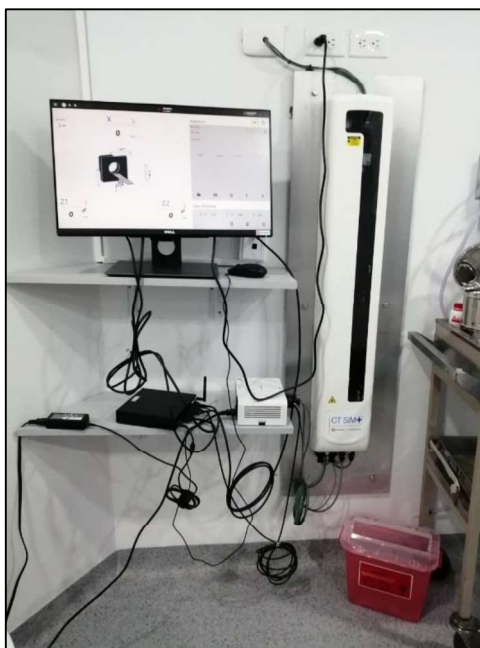
Fotografía N° 21. Los equipos de cómputo (computadoras e impresoras) no se encuentran asegurados a las mesas o presentan algún reborde que evite su caída.
