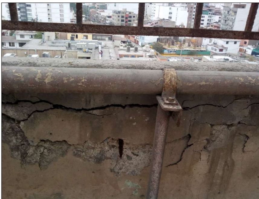
Fotografía 09. Vista de algunas afectaciones de la infraestructura de la azote que necesita ser mejorado a corto plazo.
