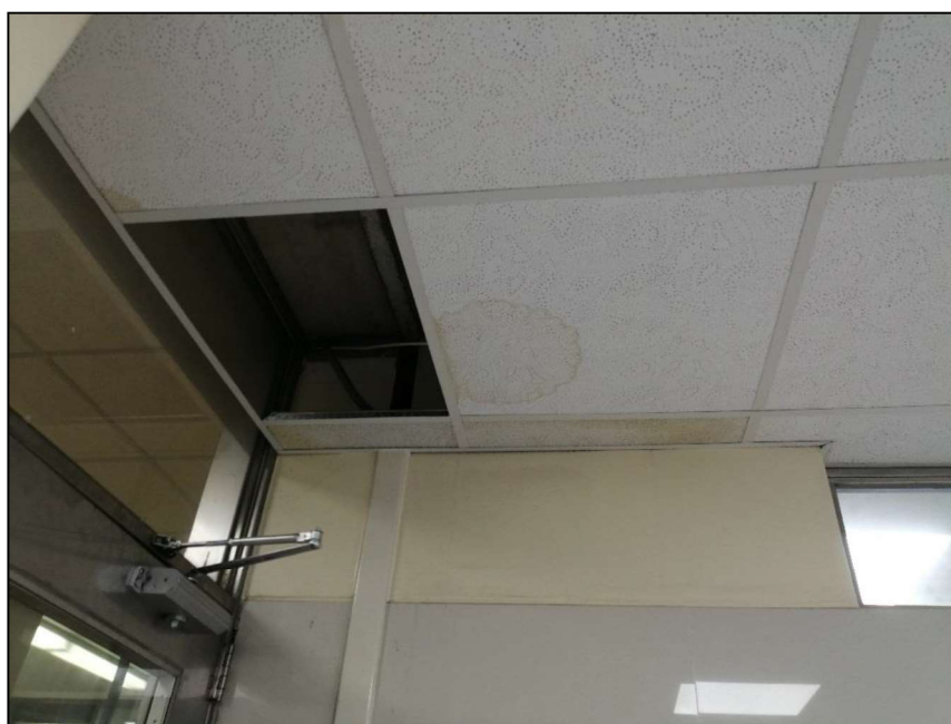
Fotografía N° 29. Ausencia y manchas de algunas baldosas en Macroscopia 01.
