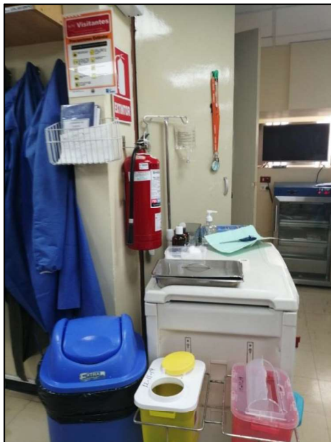
Fotografía N° 32. Obstrucción de extintores por mobiliario en UCI.
