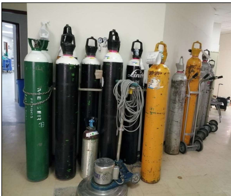
Fotografía N° 11. Los cilindros que contienen los gases medicinales no cuentan con suficientes cadenas, abrazaderas o medios de anclaje que eviten su caída en el Centro Quirúrgico.
