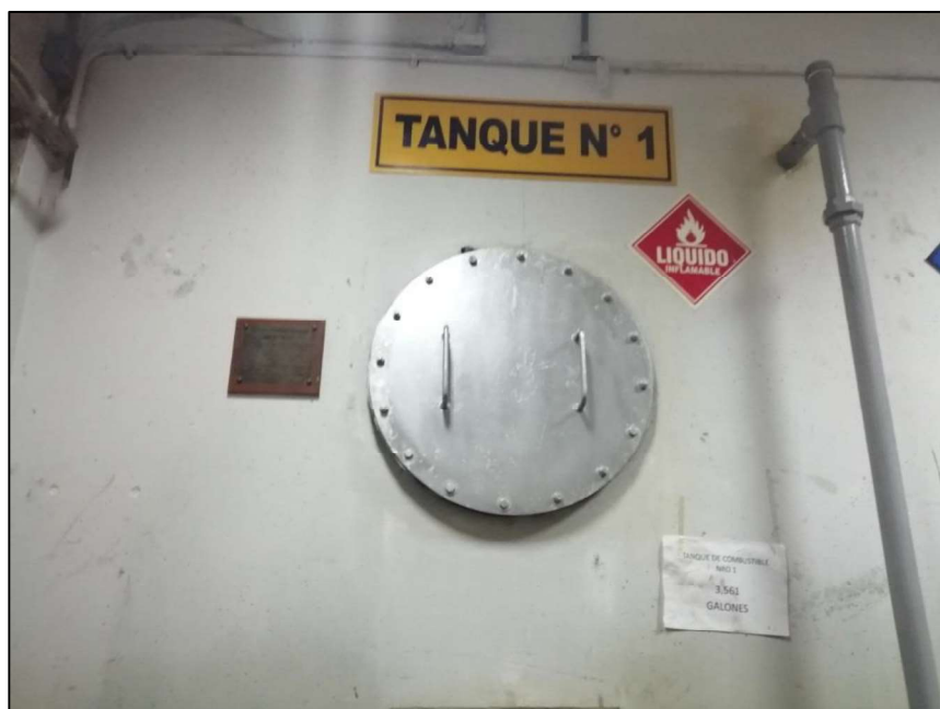
Fotografía N° 07. Depósito principal de combustible de 3,561.00 gal.
