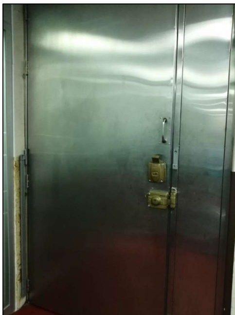
Fotografía N° 25. Puerta de ingreso en Central de Esterilización presenta desperfectos al cerrar.
