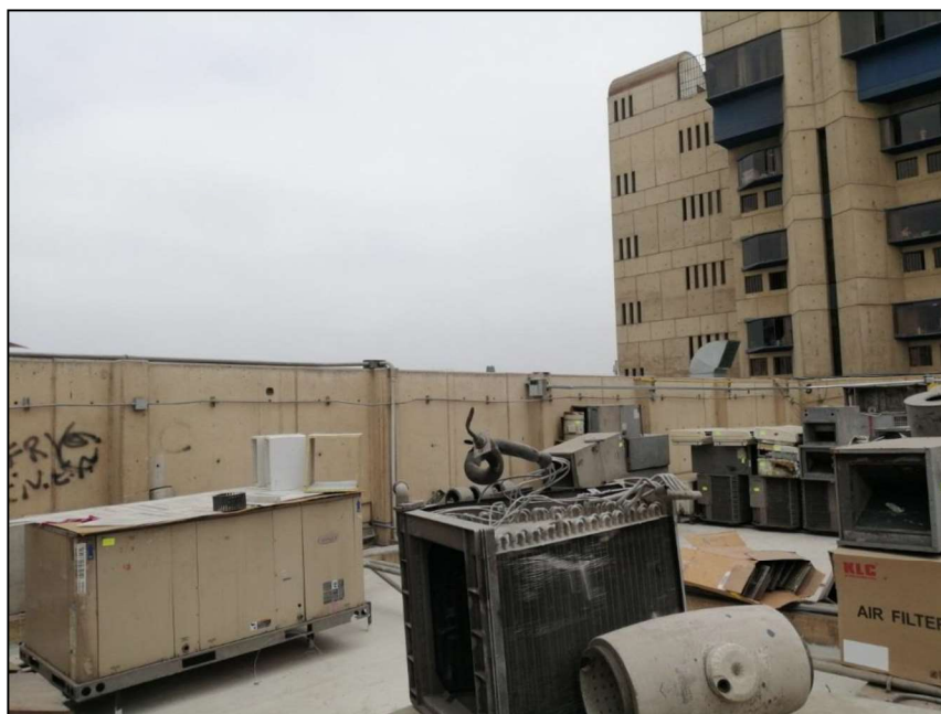
Fotografía N° 14. Vista de equipos obsoletos de aire acondicionado, ubicados en los techos.
