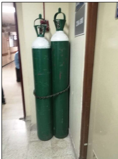
Fotografía N° 12. Los cilindros que contienen los gases medicinales no cuentan con suficientes cadenas, abrazaderas o medios de anclaje que eviten su caída en UCI.
