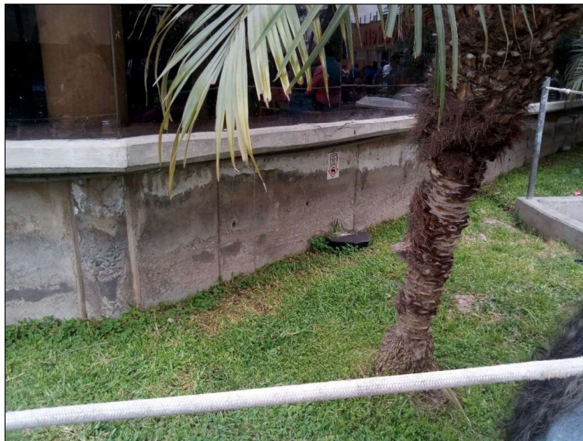
Fotografía 06. Se puede ver presencia de eflorescencia en algunos Sectores.
