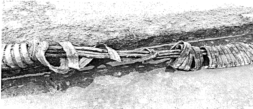
Foto 01: Afectación del cableado eléctrico por lluvias intensas
